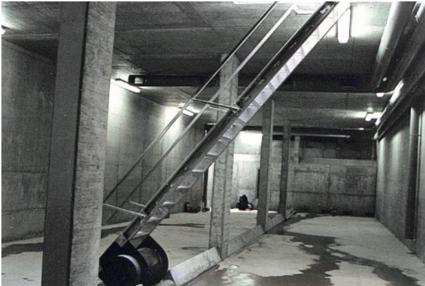
Bild 2: Innenraum eines Regenbeckens mit Schwimmleiter
